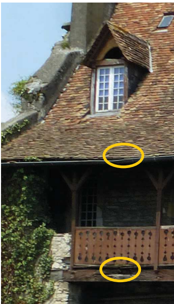
Défaut d'entretien de la gouttière et mise en péril de la structure de la galerie.
