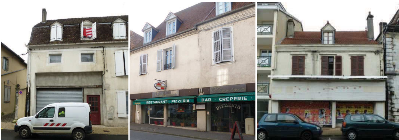
« Décroustage » des enduits de protection de la façade maçonnée en moellons.
