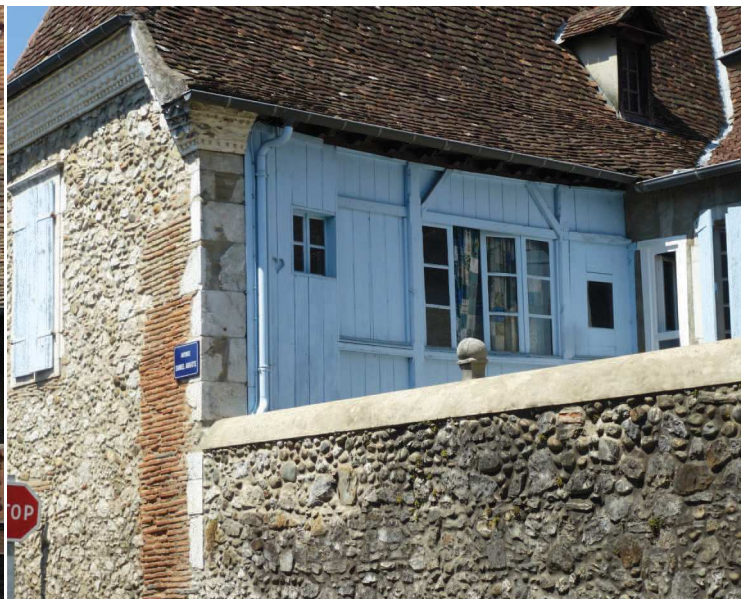
« Décroutage » des enduits de protection de la façade maçonnée en moellons.
