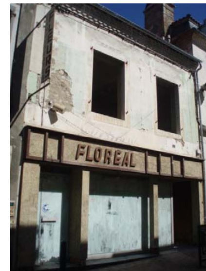
Maison de centre ville avec local et logement vacants
