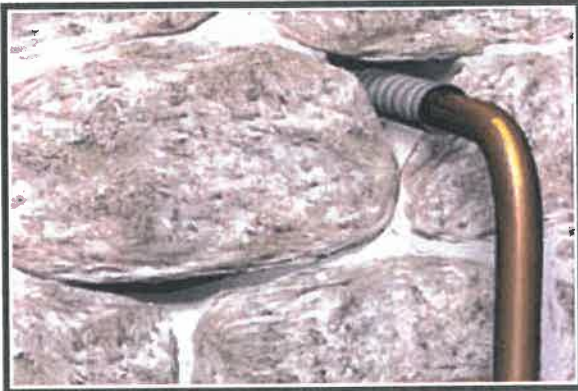
Situation initiale avant colmatage
